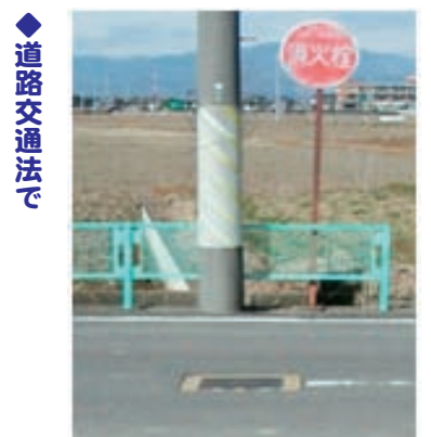
▲地下式の水道消火栓 (例)
