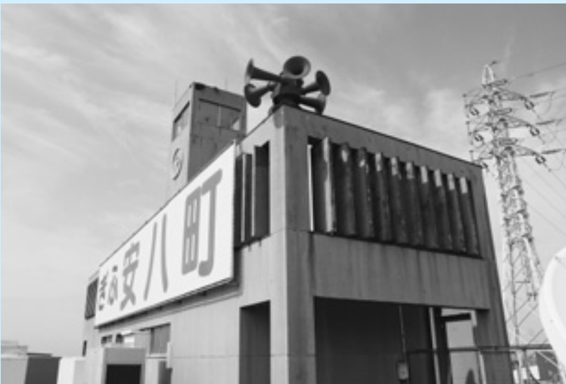
庁舎屋上に取り付けられているサイレン
