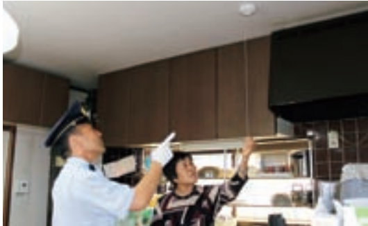
▲ 住宅用火災警報器がしっかり設置されてますね
