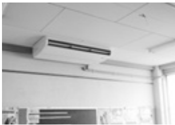
中学校に設置予定のエアコン
