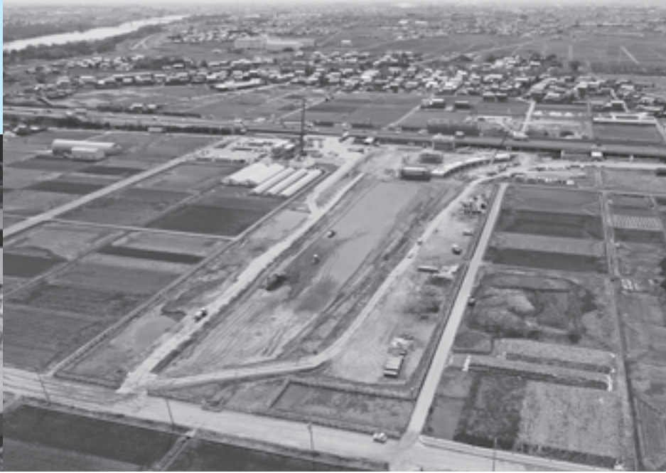
安八スマートインターチェンジ建設工事始まる (H29.3.25 現在)
