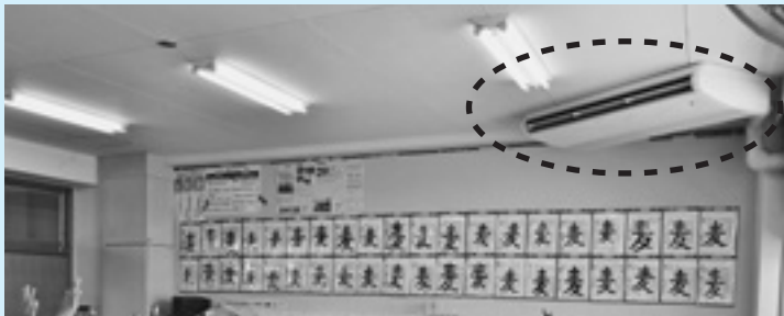
全小中学校にエアコン設備を整備 (写真は名森小)
