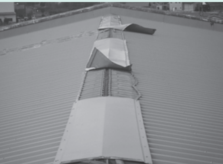
台風21号で屋根の一部が剥がれた牧小学校体育館
