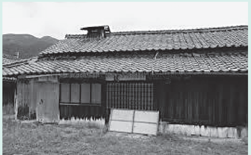
放置されている空き家
