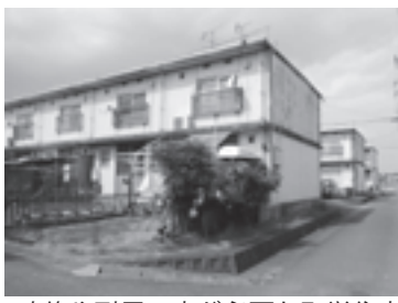
改修や耐震工事が必要な町営住宅
