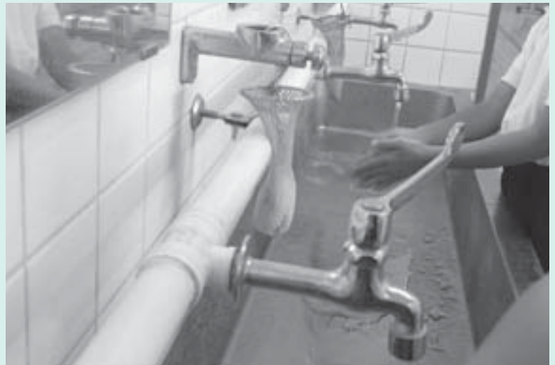
小中学校で取り替えを予定している非接触型蛇口
