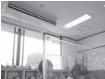
こども園に設置されたエアコン
