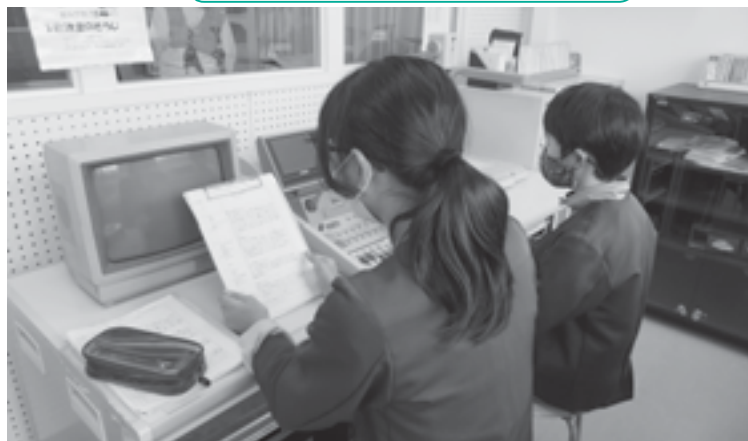
改修が必要な名森小学校の放送設備
