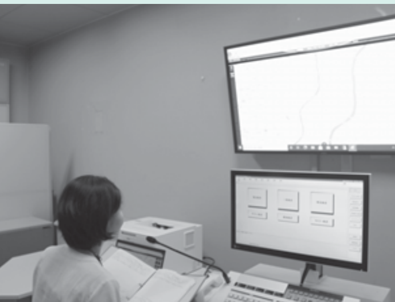
デジタル化整備が完了した防災行政無線親局（役場1階無線室）
