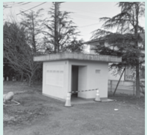
現在使用禁止中の中央保育園跡地内のトイレ
