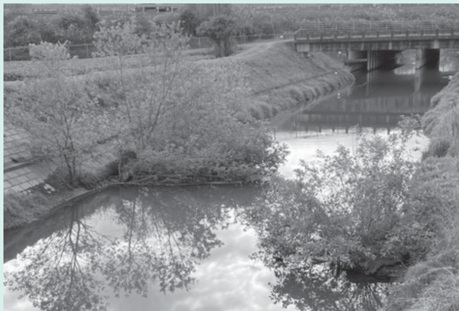
のり面から木が生えている中須川
