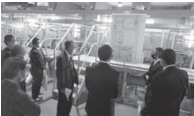
上水道配水場内で設備の説明を受ける議員
